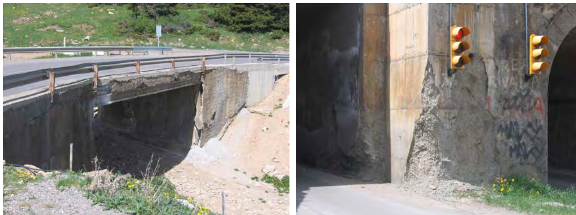
Figura 10. Ejemplos de mal estado de conservación del hormigón.
