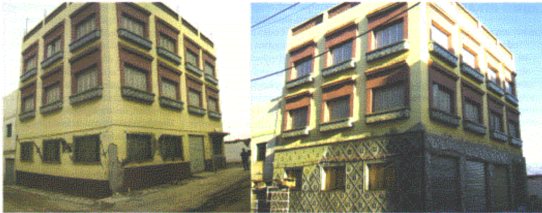
Figuras 5 y 6. Edificio con pilares dañados reparado con un muro de hormigón que abarca toda la planta baja. / PATRICK MURPHY
