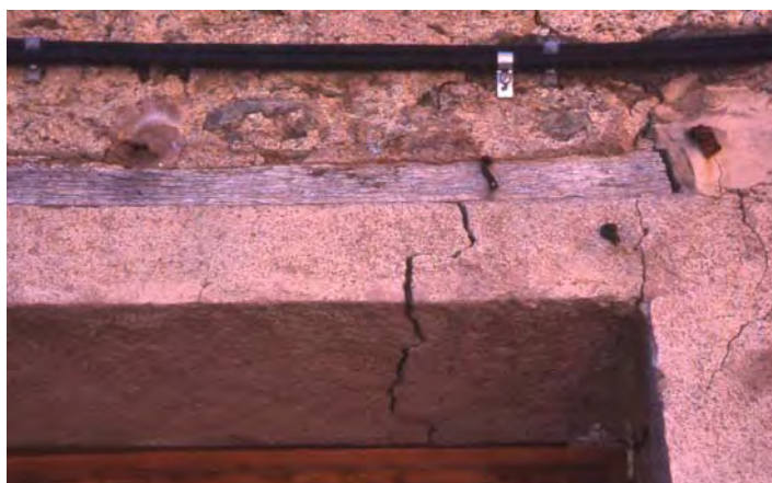
Figura 15 : Desplazamiento y rotura de dintel.
