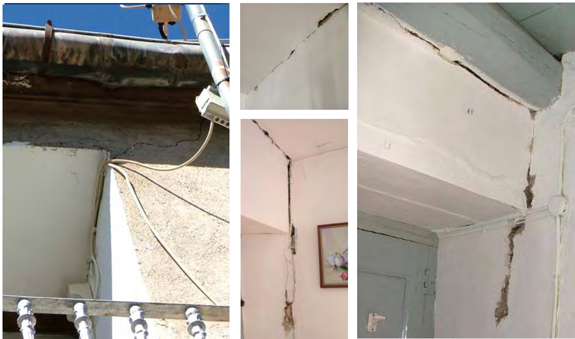
Figura 8 : Daños de Grado 2 observados en viviendas de vulnerabilidad clase A.
