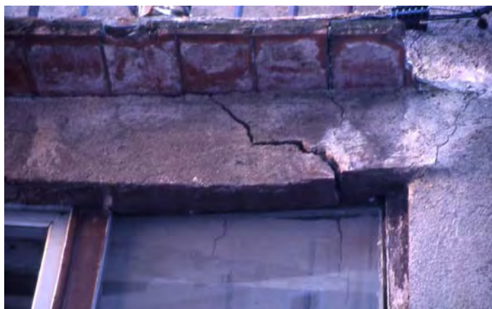
Figura 14 : Rotura de dintel.
