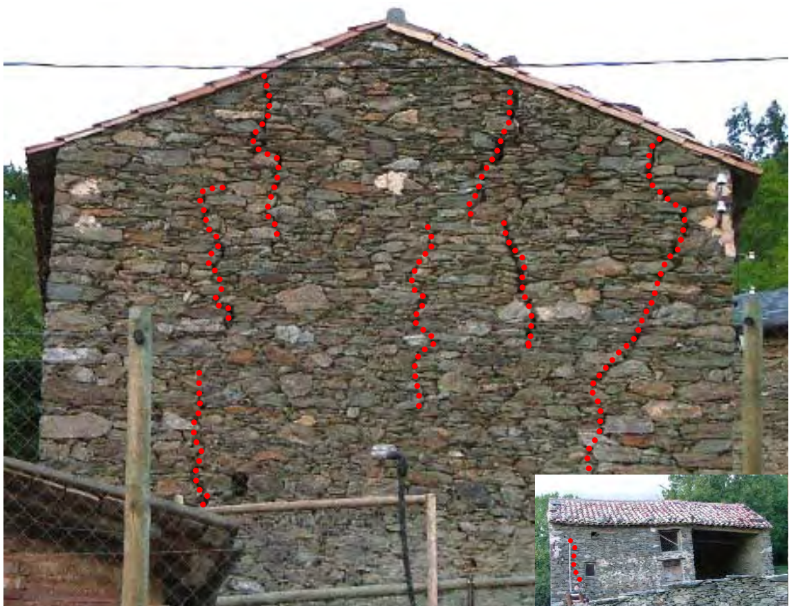
Figura 9 : Daños de Grado 3 observados un estructura de vulnerabilidad clase A.
