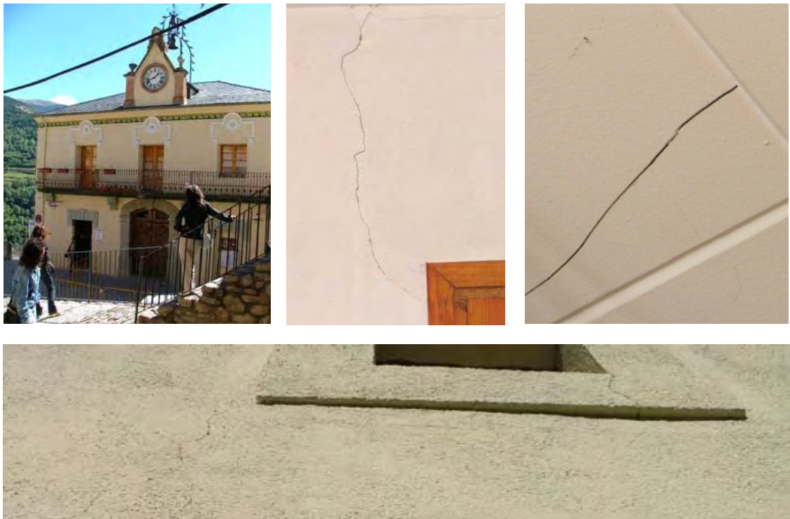
Figura 7 : Daños de Grado 1 en el Ayuntamiento de Queralbs de vulnerabilidad clase B.
