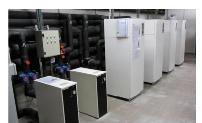
Sala de màquines de la instal·lació geotèrmica de l'edifici Sant Josep (3000 m 2 ) a la Vall de Núria (Girona)
