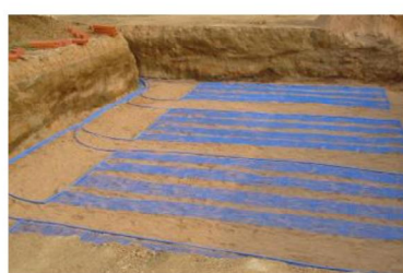
Col·lector horitzontal per a la climatització d'un edifici d'oficines de 80 m 2 a la població de Palafolls (Girona)
