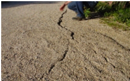
Photo 1. Observations des fissures près de la plage du Club Méditerranée. Situation sur la figure 3.
