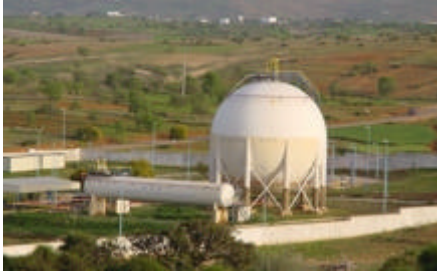
Photo 5. Site de l'accélérographe GAS au niveau de l'installation de GPL d'Izmourenne.
