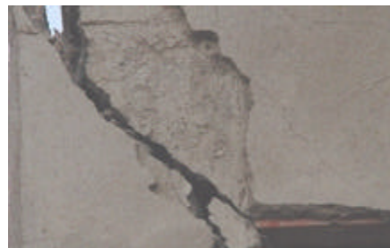
Photo 16. Détail des dégâts. Situation sur la figure 3.
