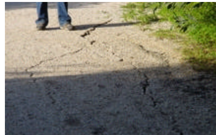
Photo 2. Observations des fissures près de la plage du Club Méditerranée. Situation sur la figure 3.
